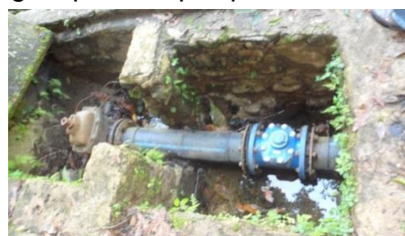
FIGURA 3 - PELIGROS EN LA LÍNEA DE CONDUCCIÓN.
